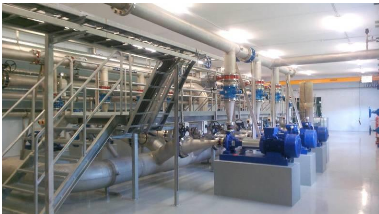
Foto 5.5 Ahtme veetöötlusjaama survetõstepumbad
